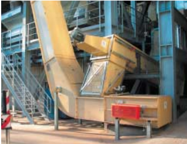
Steilförderer in einem Spanplattenwerk
